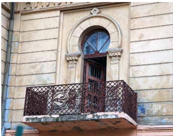
Іл. 49. Балкон у правому крилі північно-західного фасаду особняка Д. О. Алчевського в Харкові. Сучасне фото В. М. Ряполова
